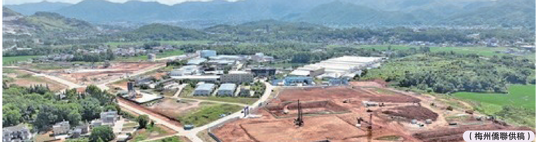
蕉嶺縣廣福工業園區基礎設施首期項目建設如火如荼推進。(丘林強 攝)
